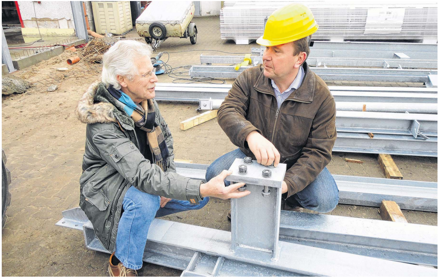
Architekt Roger Gielson aus Alt-Schwerin und Ingenieur Nenard Geißler (rechts) überprüfen, ob alle Stahlverbindungen exakt sind.
